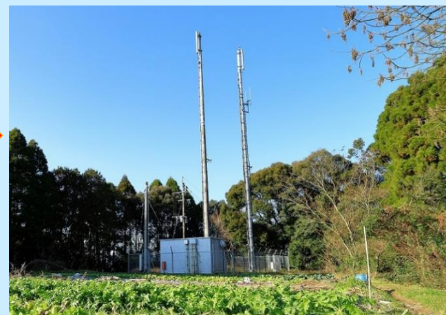
活用可能なスペースに通信基地局を設置
